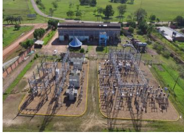
SUBESTACIÓN SAN JOSÉ
