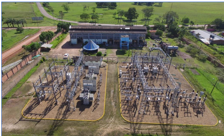
Imagen 3. Subestación San José del Guaviare
